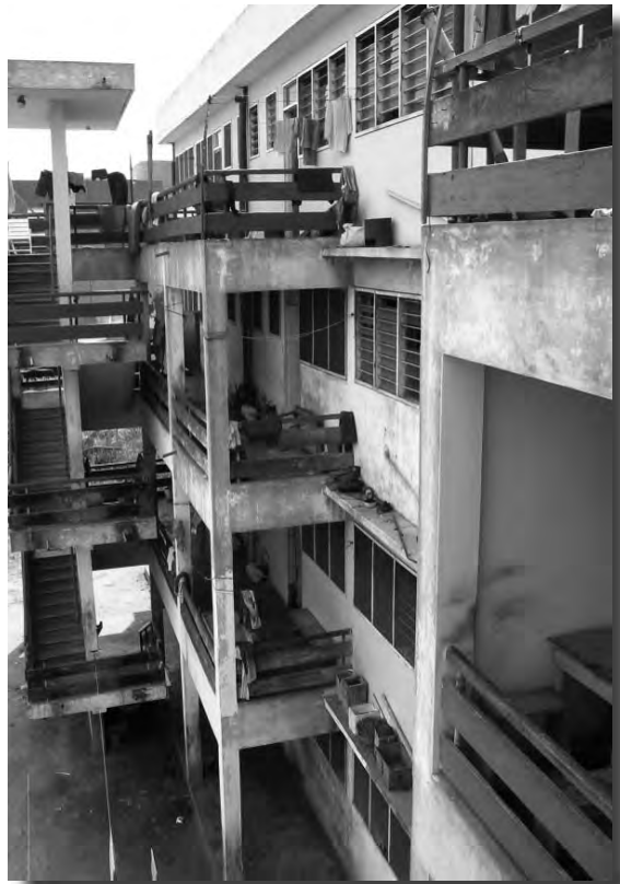
Appartements locatifs dégradés à Tema Community V
