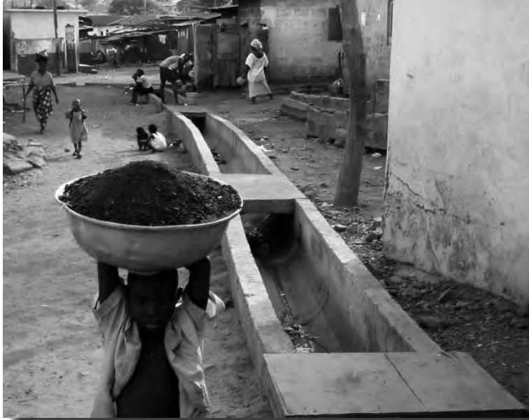
Aménagement d'une rigole d'assainissement à Lagos Town, enjeu de la mobilisation locale
