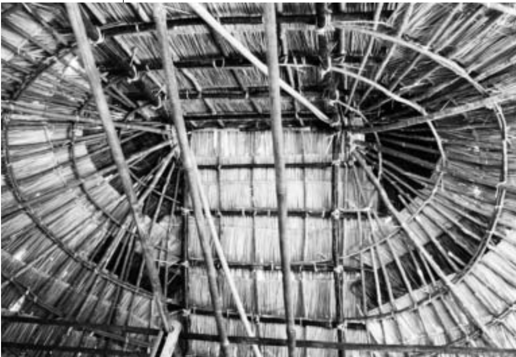
Toiture de la maison de l'essart, village de Makkoud, district de Nalae.
