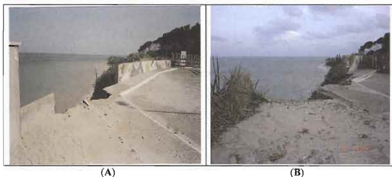
Figura 2 – Destruição do mirante do Farol do Cabo Branco, em Ponta do Seixas, ponto mais oriental das Américas, em João Pessoa – PB. Fotos obtidas em janeiro de 2005 (A) e janeiro de 2006 (B).
