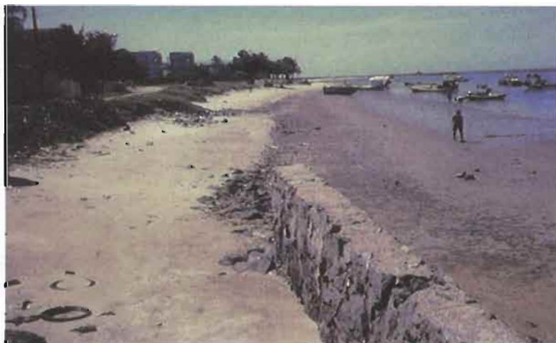
Figura 5 – Vista da praia do Janga em Olinda, com o que restou de uma rua após o mar ter destruído o muro de contenção e levado o calçamento. No canto inferior esquerdo, uma “boca de lobo” do sistema de esgoto. Ao fundo, lado direito na parte superior, os arrecifes naturais receberam reforço de pedras.
