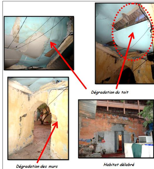
Figure 31. L'état de dégradation des maisons squattées
