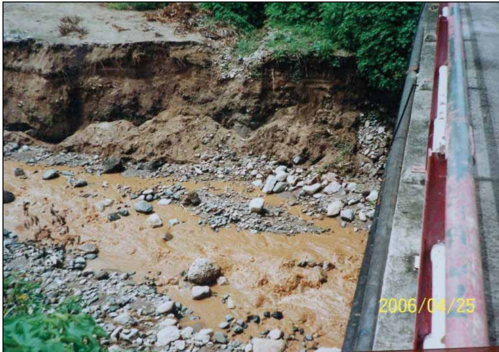
Photo 11 : Affouillement des bas-côtés des ponts lors de la même pluie
