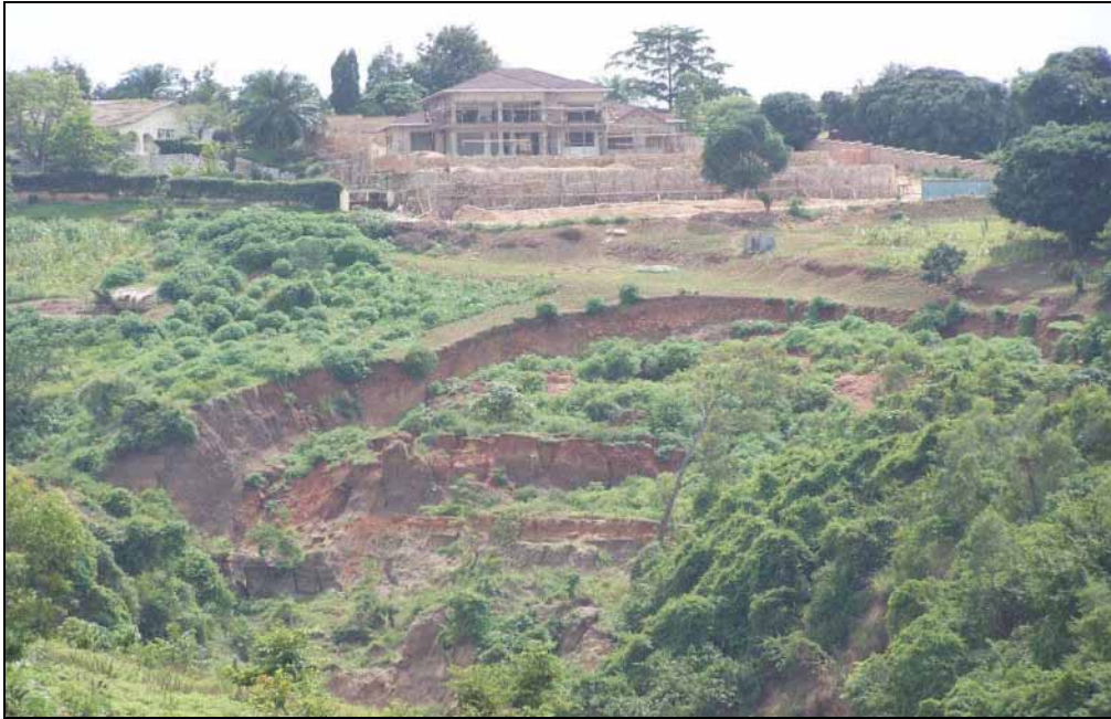
Photo 9 : Bâtiment en cours de construction au dessus du ravin de la Ntahangwa menacé par un glissement de terrain
