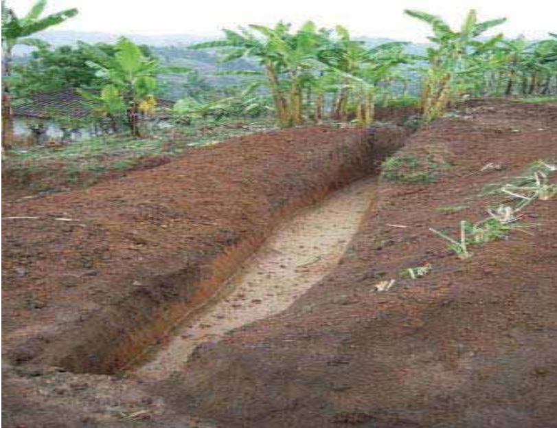
Photo 08 : Fossé de retenue d'eau ruisselant sur les toits et cours des maisons
