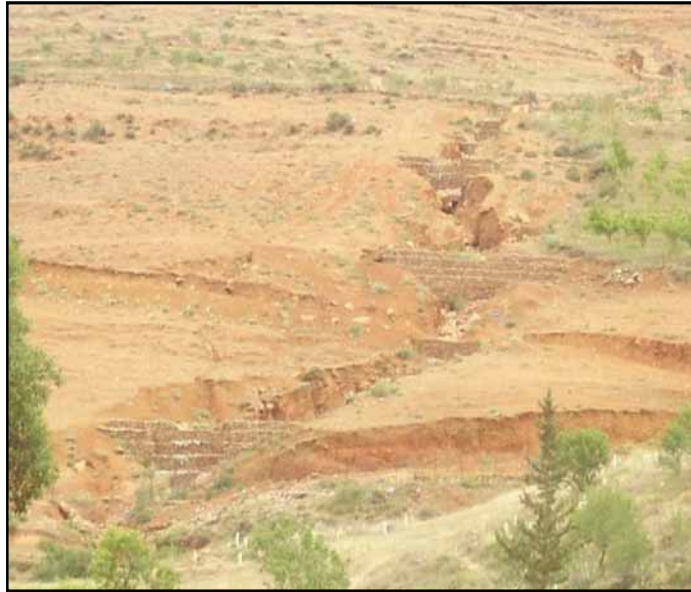
Photo 8 Série de seuils en gabions (taux d'atterrissement moyen à faible, érosion active).
