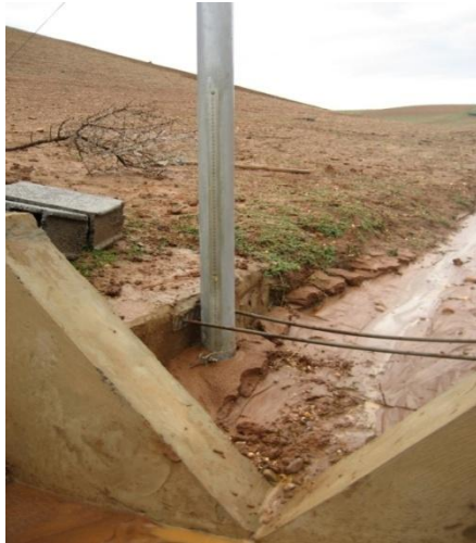
Photo 4 : Déversoir comblé suite à une crue
