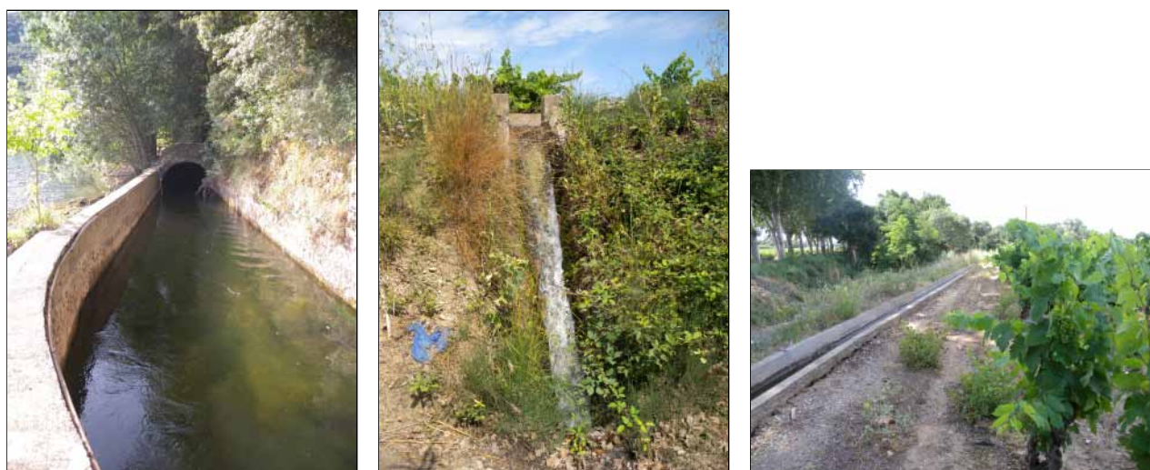
(a) Canal rive droite après le répartiteur à Saint-Guilhem-le-Désert, juin 2012. (b) Retour de l'eau dérivée au réseau hydrographique à Pouzols, juillet 2012. (c) Goulotte dans un champ de vigne à Pouzols, juillet 2012.
