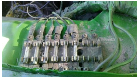
Figura 1. 67 Caja de fusibles
