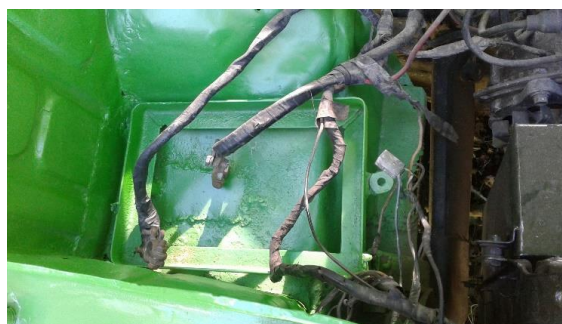
Figura 1. 64 Cableado de la batería en mal estado
