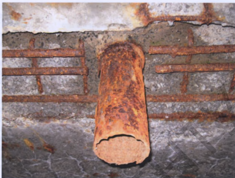
Рисунок 2 – Разрушение бетона, разрыв рабочей арматуры в местах установки водоотводных трубок крайней плиты пролета № 3 моста через р. Диражня на км 61,430 автомобильной дороги М-3 Минск – Витебск
