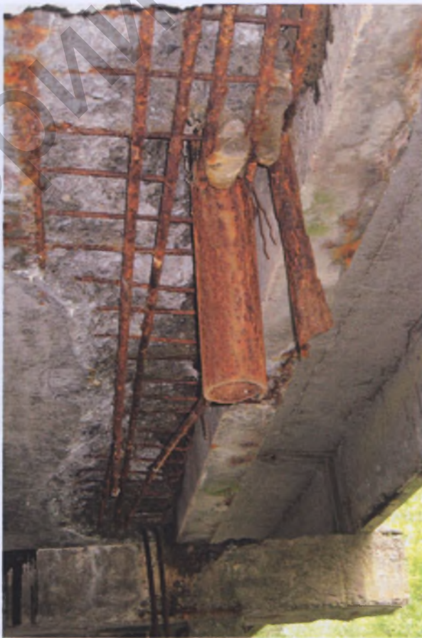
Рисунок 1 – Разрушение бетона, разрыв рабочей арматуры в местах установки водоотводных трубок крайней плиты пролета № 2 моста через р. Двиноса на км 61,142 автомобильной дороги М-3 Минск – Витебск
