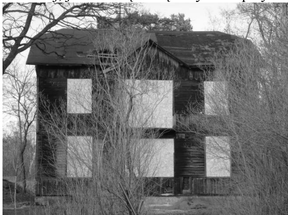
Rys. 8 Budynek w Warszawie Radości po eksmisji lokatorów w wyniku zagrożenia katastrofą budowlaną
