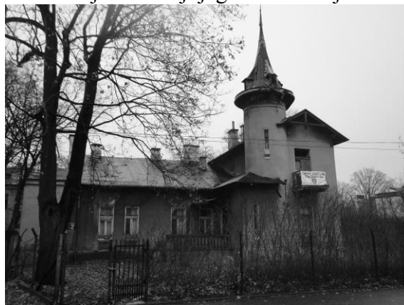
Rys. 7 Charakterystyczna willa z czasów "letniskowych" w Grodzisku Mazowieckim, która stanowi własność prywatną. Zrujnowana objęta jest obecnie gminnym programem rewitalizacji
