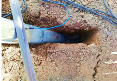
(a) Deformação provocada ao nível do solo do prumo P6
