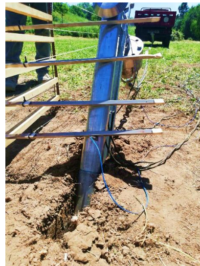
(f) Vista superior da deformação do prumo P6
