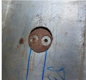
Figura 114 - Medalha danificada de célula de carga instalada subsolo
