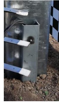
(a) Localização da rotura da fixação metálica ao prumo.
