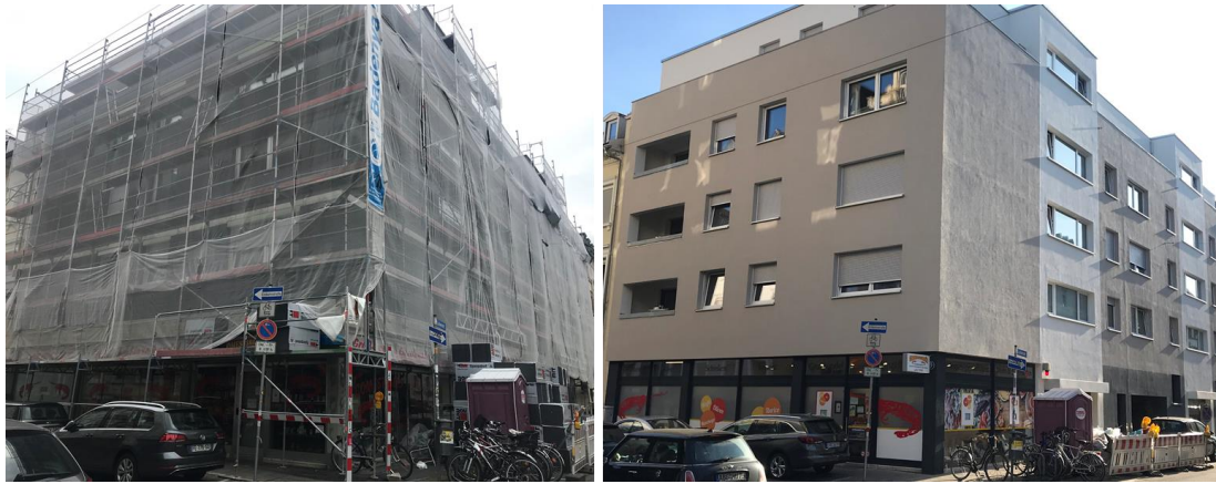
Abbildung 2-2 Beispielgebäude mit WDVS (links: Dämmstoff wird an die Fassade geklebt; rechts: Komplettaufbau aus WDVS)
