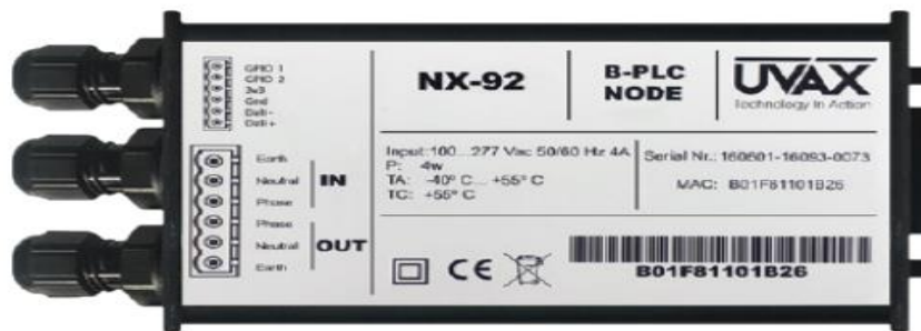
Ilustración 91. Nodo PLC Uvax con conexión dentro de báculo.
