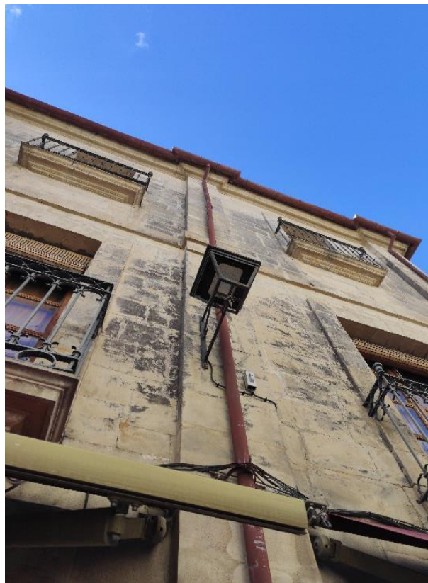
Ilustración 70. Farol ornamental con bloque óptico instalado.
