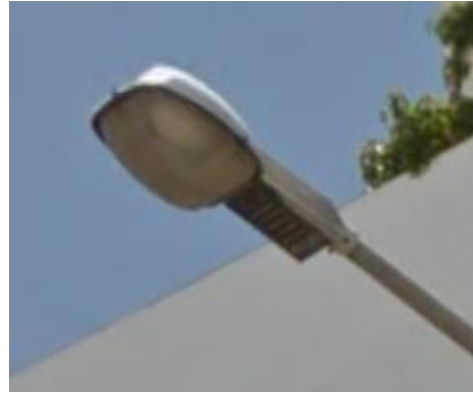
Ilustración 51. Luminaria Vapor de sodio.
