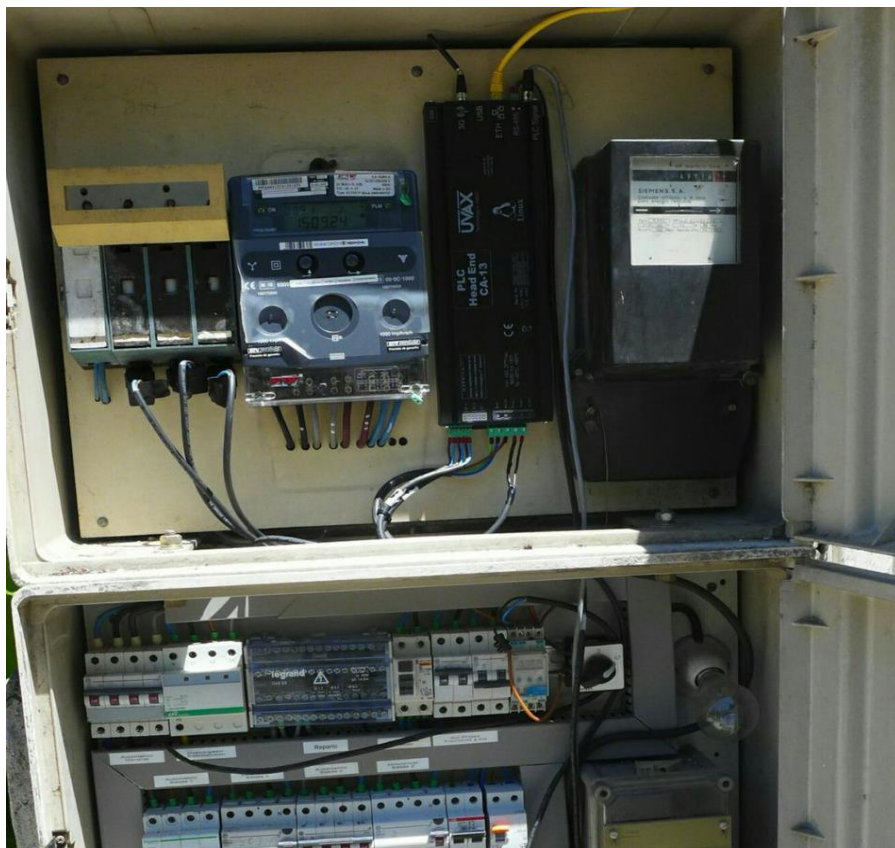
Ilustración 94. Instalación en cuadro de mando de sistema Uvax .
