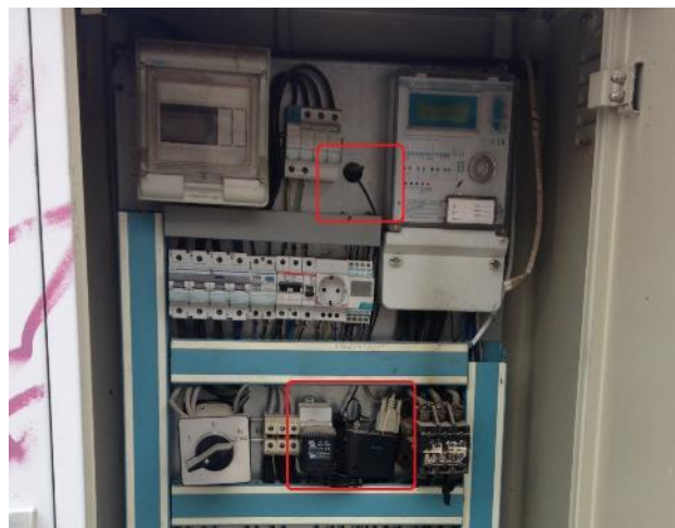
Ilustración 46. Módem marca Siemens con antena.
