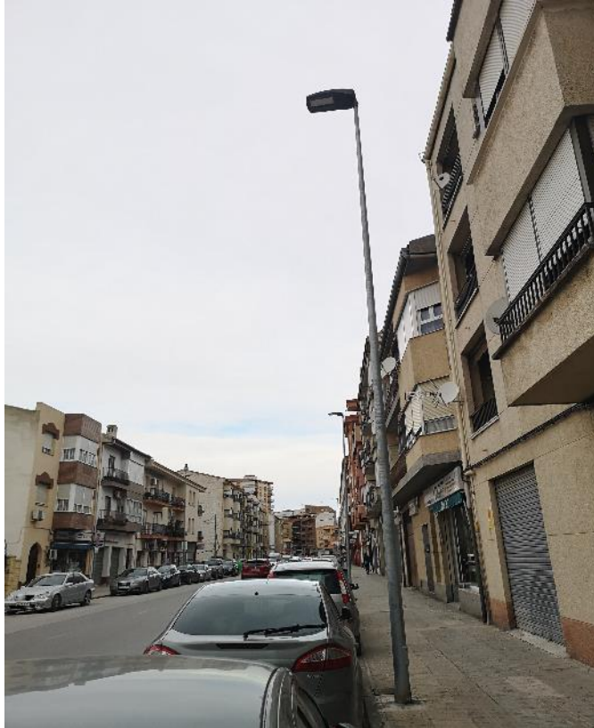
Ilustración 67. Luminaria TECEO 2 sobre báculo sin dispositivo de telegestión.
