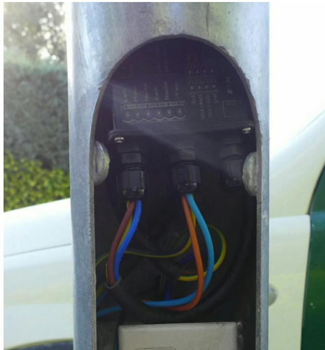
Ilustración 96. Nodo PLC de Uvax instalado en báculo.
