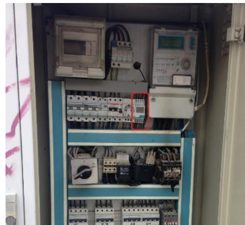
Ilustración 43. Reloj astronómico instalado.
