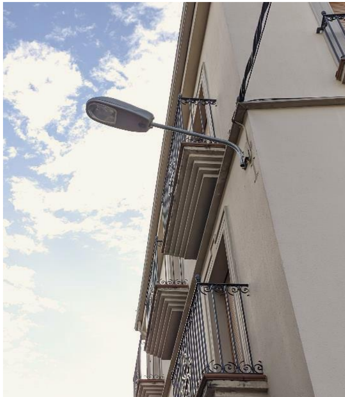
Ilustración 65. Luminaria de vapor de sodio PHILIPS ajena al proyecto, para comparación estética.
