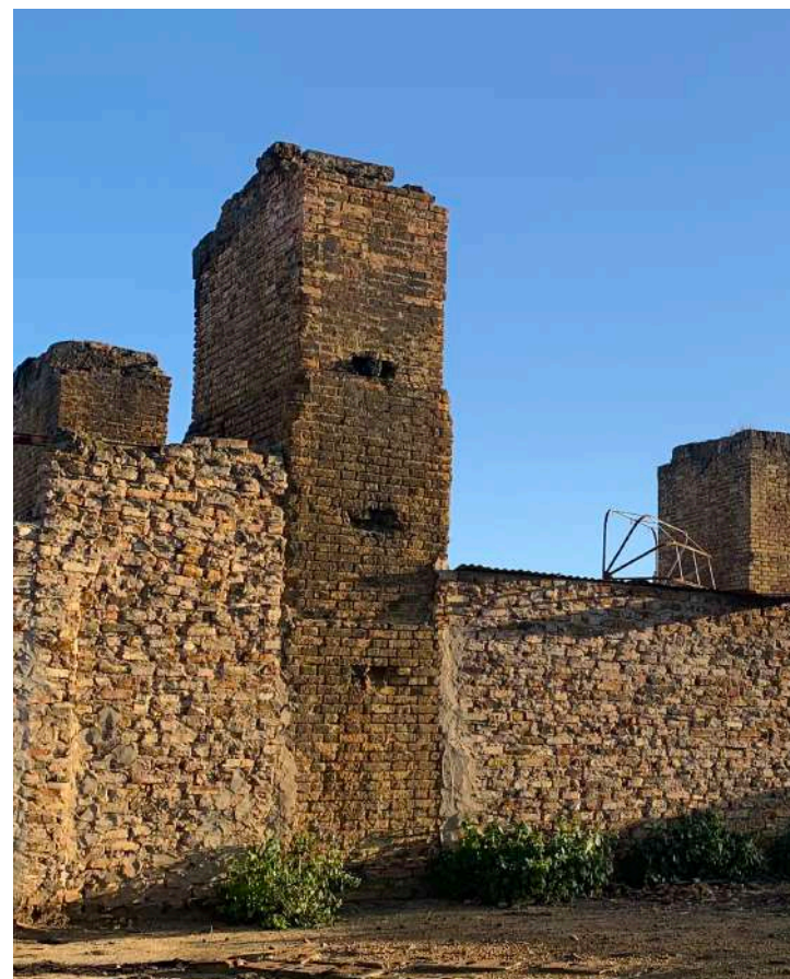
IMAGEN 16: Restos de la pantalla 14 del depósito Sur; archivo personal. Obsérvese los restos de una viga de madera, que aún permanece empotrada en la pilastra, en su orificio reservado para esta función en la cota superior.
