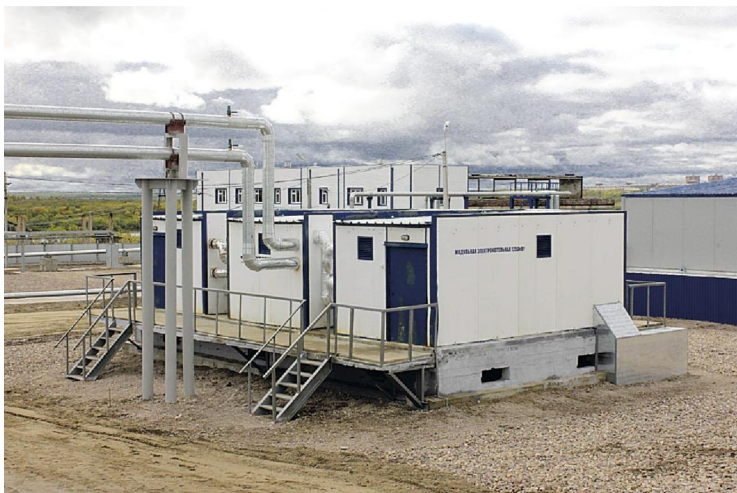
Рис. 5. Станция очистки воды
