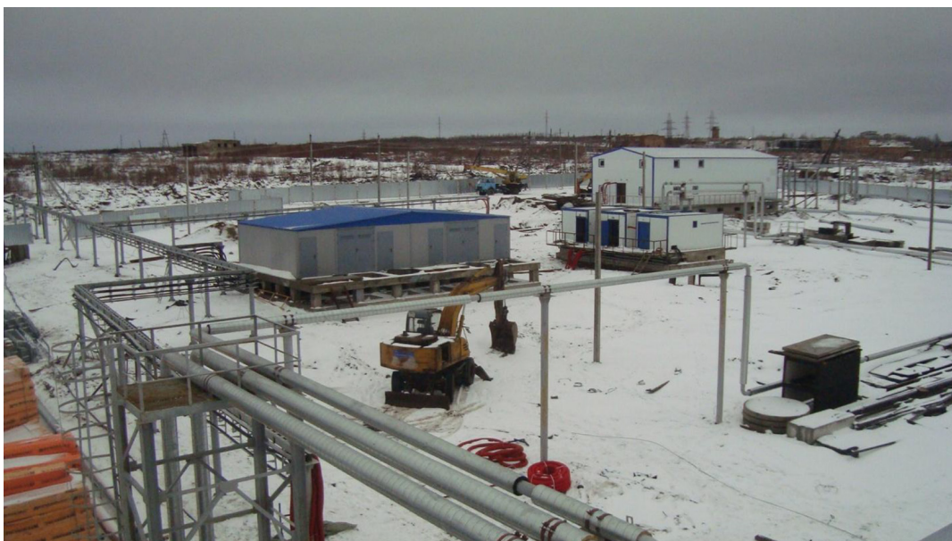
Рис. 4. Комплекс блочно-модульной станции водоподготовки
