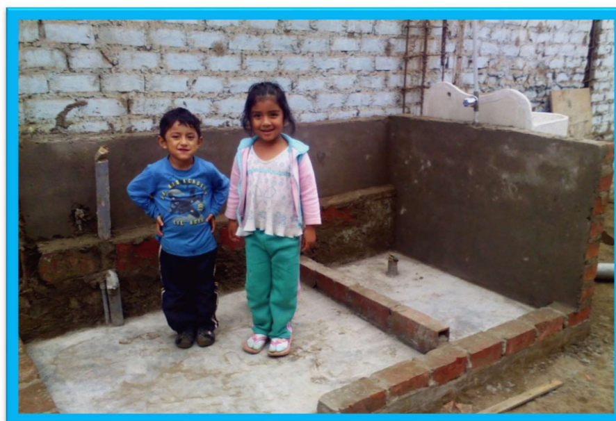
Foto N°6: Niños de la Mz. J lote 11 de la habitación Juan Pablo II, Cód. 11, mostrando felices las instalaciones realizadas al interior de su vivienda.
