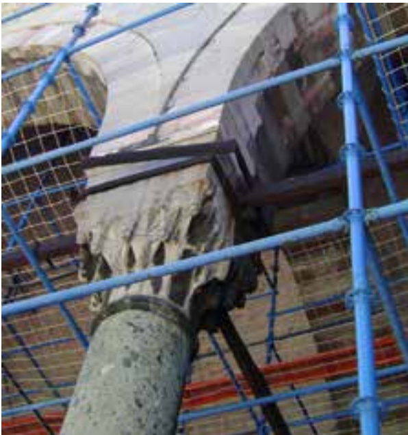
Fotoğraf 12. Korozyona uğramış sütun başlık kuşağı
