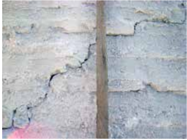
Fotoğraf 21. Kubbelerde çatlaklar
