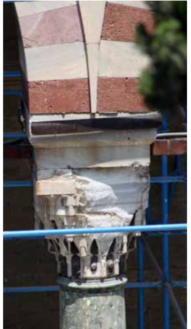
Fotoğraf 13. Korozyona uğramış sütun başlık kuşağı
