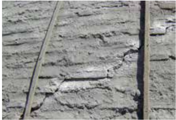
Fotoğraf 22. Kubbelerde çatlaklar
