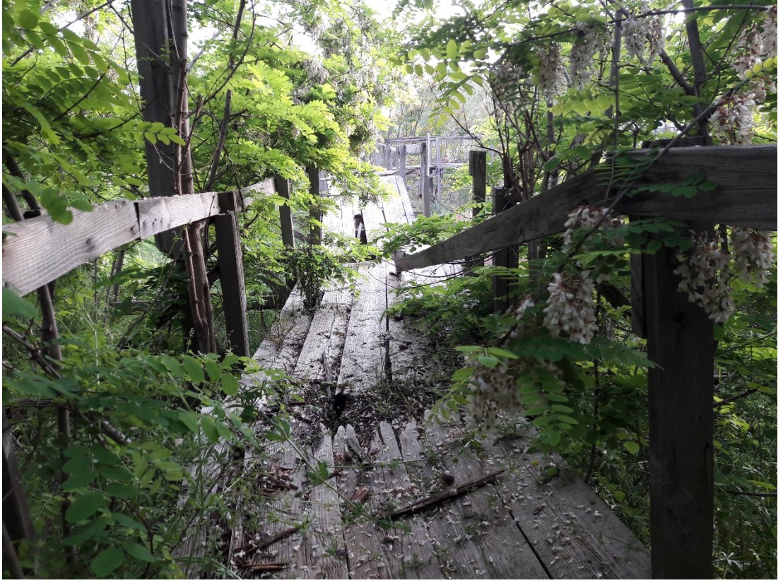
Şekil 4.1.7: Büyük Saray arazisinde ahşap yürüme yollarının durumu.
