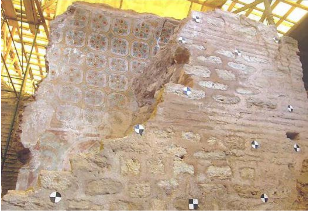
Şekil 3.26: 23 Numaralı Mekana Ait Duvar ve Fresko 205
