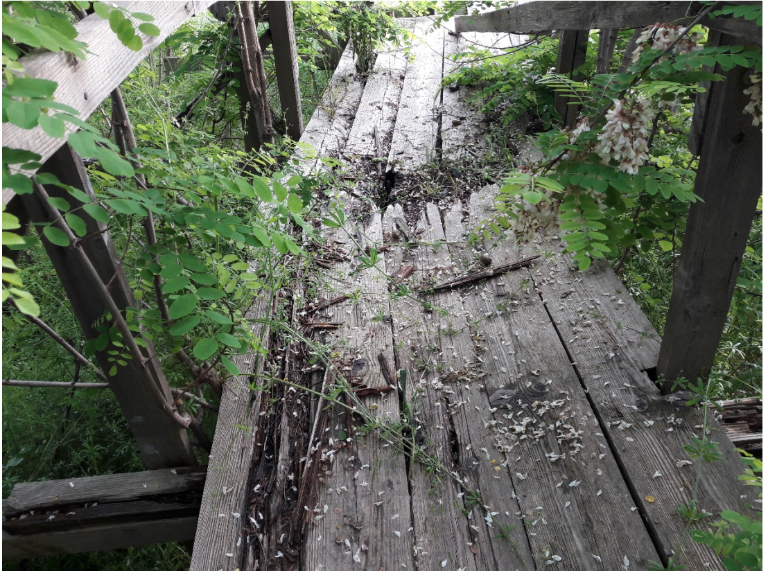
Şekil 4.1.8: Büyük Saray arazisinde ahşap yürüme yollarının durumu.
