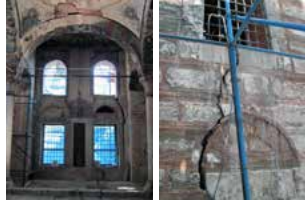
Fotoğraf 38-39. Kuzeybatı-güneydoğu doğrultusunda meydana gelen ayrılma ve cepheye yansımaları
