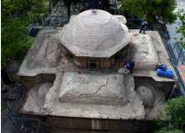
Fotoğraf 35. Üst örtü sistemindeki çatlaklar
