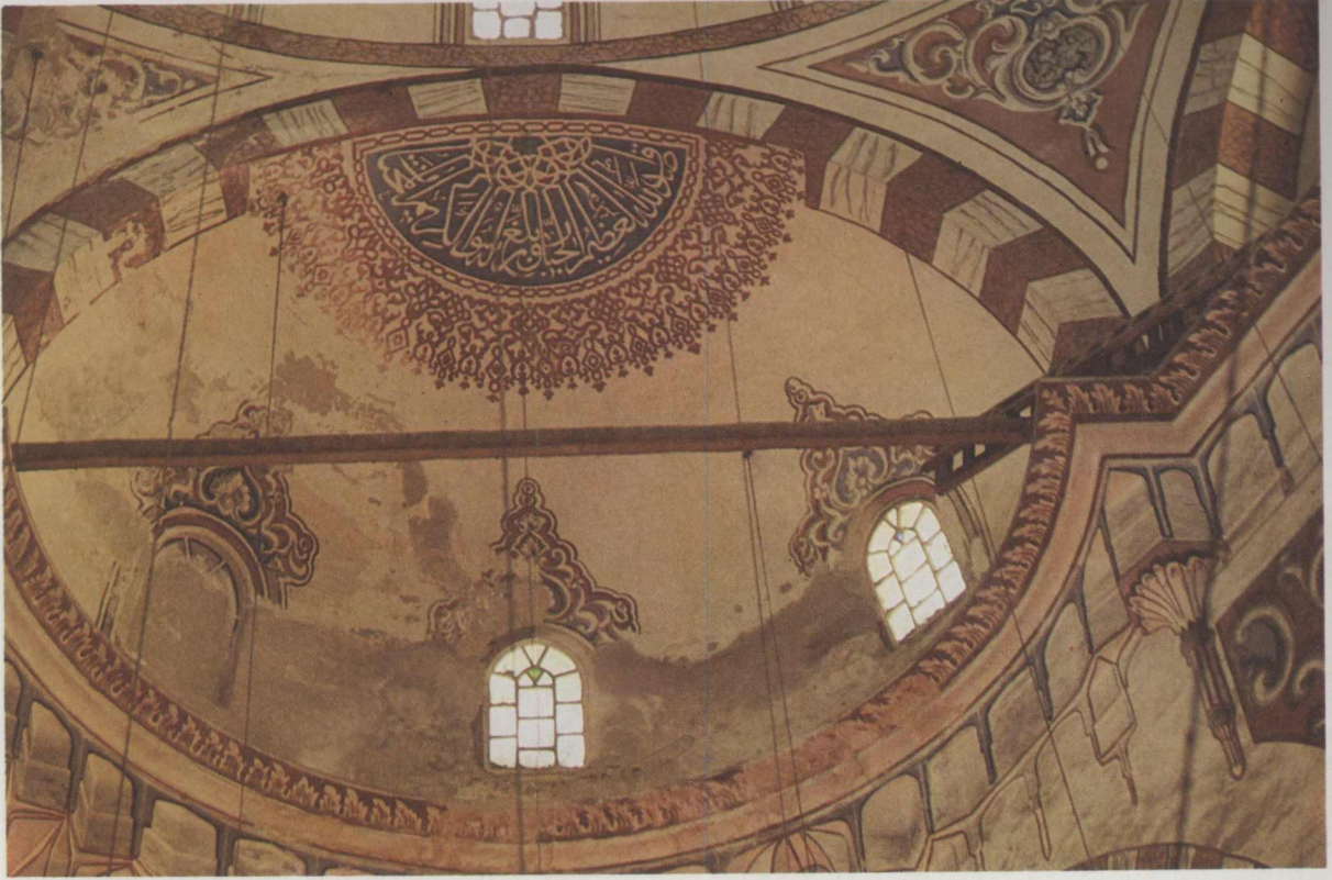
Resim 24: Cami içerisinde çeyrek kubbelerden biri. (Restorasyon öncesi tahribatı)
