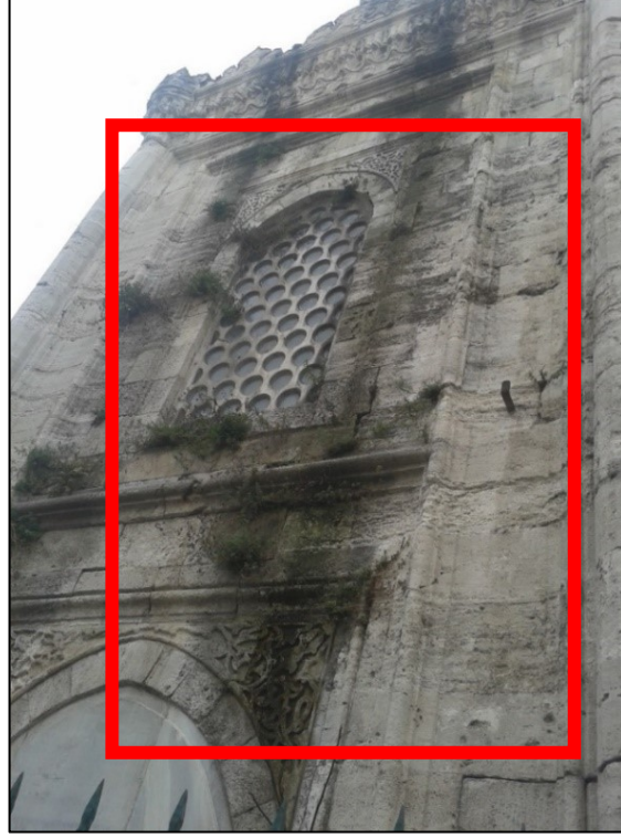
Resim 6.2 Hüseyin Paşa Türbesi Batı Cephesi Yüzeyinde Oluşan Yosunlanmalar
