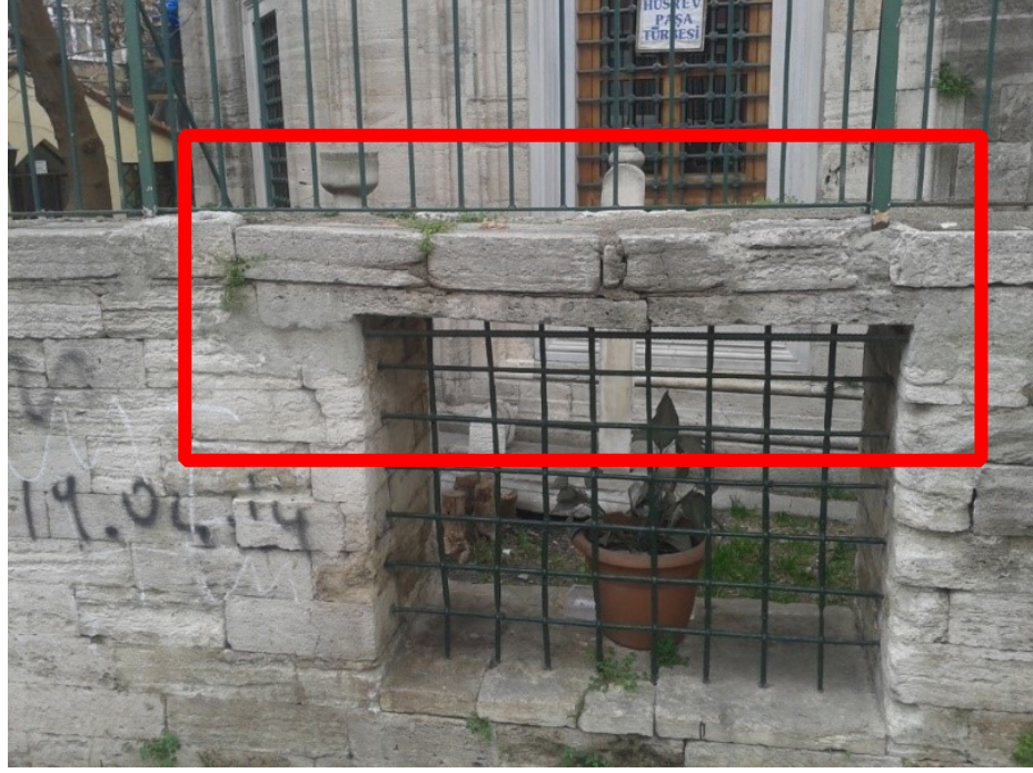
Resim 6.6 Hüsrev Paşa Türbesi İhata Duvarındaki Oynama ve Aşınmalar
