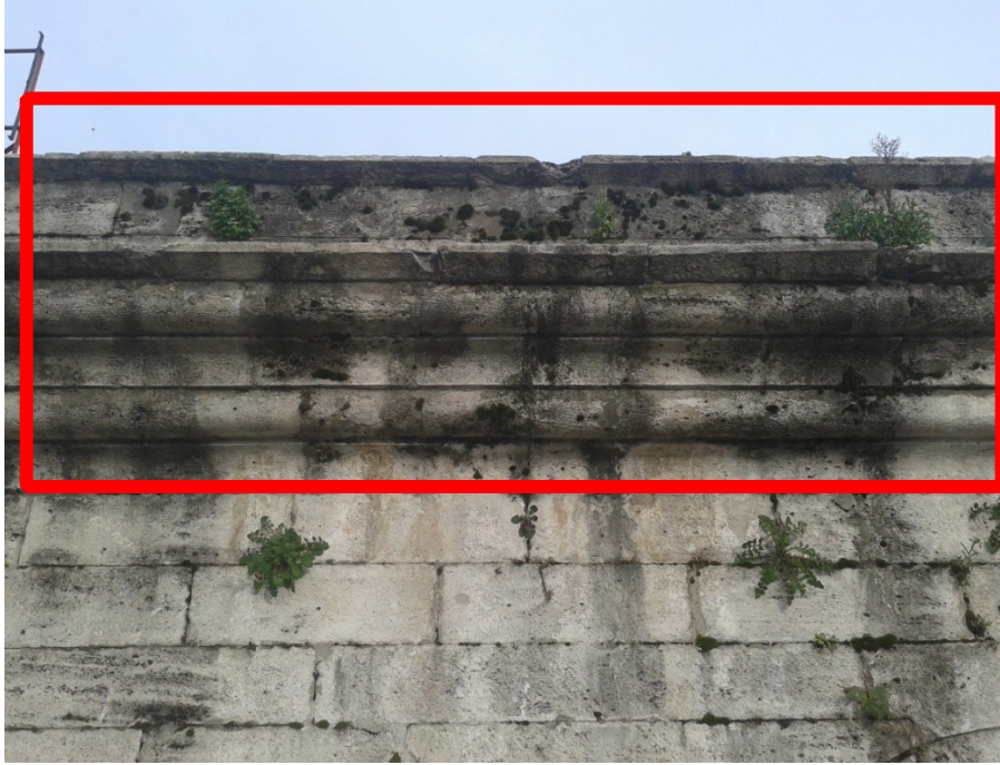
Resim 6.12 Saçaklarda Malzeme Kaybı ve Bitkilenme
