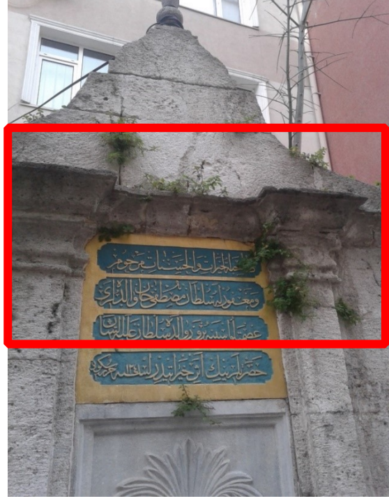
Resim 6.31 Örtü ve Saçaktaki Bozulmalar
