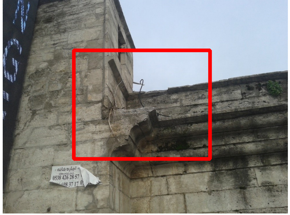
Resim 6.16 Köşe Kuledeki Hasarlar
