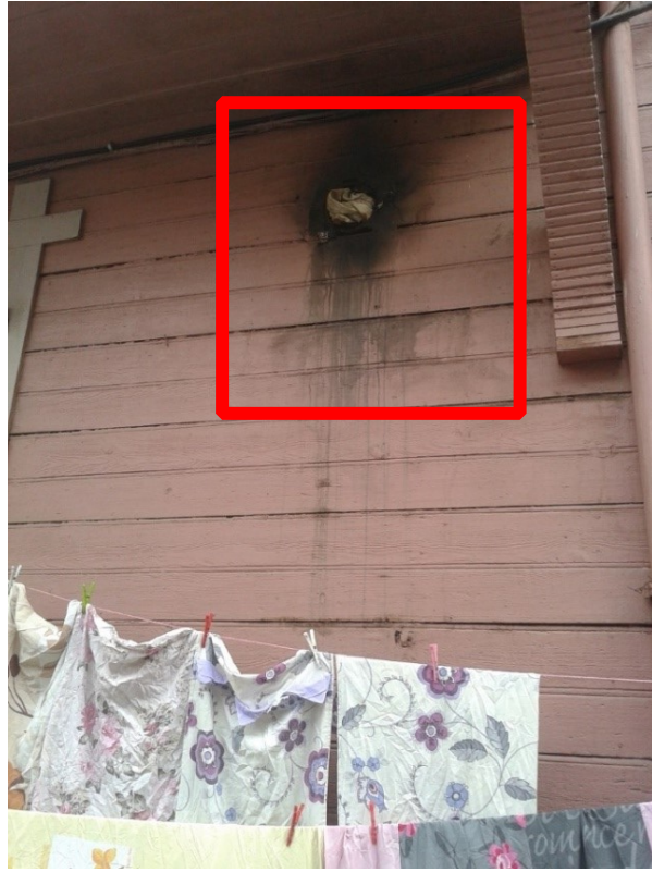
Resim 6. 44 Yanlıř Kullanımdan Kaynaklanan Ahřap Kaplama Bozulmaları
