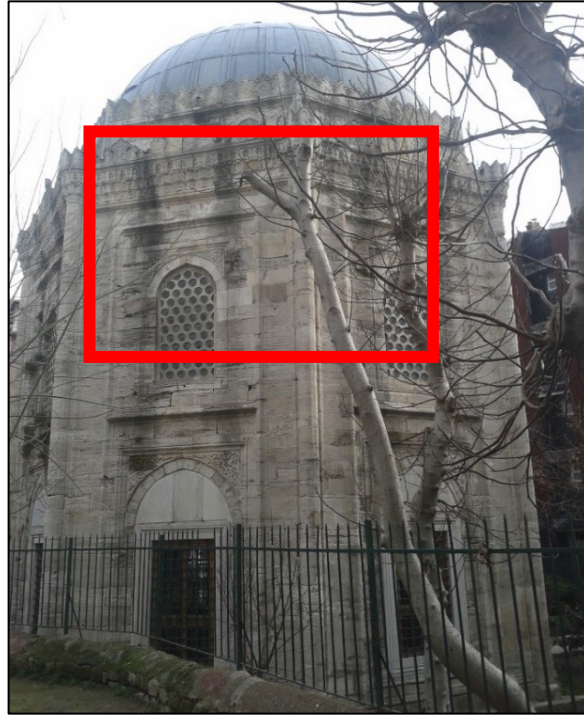
Resim 6.3 Hüseyin Paşa Türbesi Yüzey Erimeleri ve Kirlenmeler
