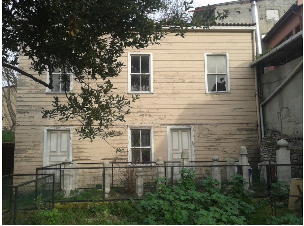
Resim 6.10 Hindular Tekkesi Batı Cephesi Ahşap Kaplamalarının Çürümesi
