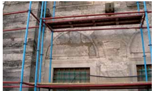
Fotoğraf 11. Mermer yüzeylerde, çok hafif oranda, is, toz ve alçıtaşından oluşmuş, henüz kabuk haline gelmemiş kirlilik ile çörtten altı gibi yağmurdan tamamen korunan bölümlerinde kabuk haline gelmiş alçıtaş oluşumları ve çimento bağlayıcılı harç ile uygun olmayan onarımlar.
