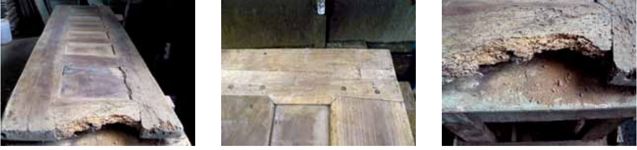
Fotoğraf 12. Cami ahşap elemanlarında yoğun böcek sorununun genel ve detay görünümleri.
