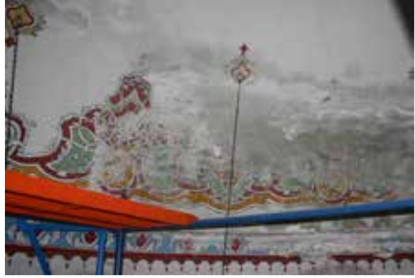
Fotoğraf 1 KK4 (Köşe Kubbe 4) Kubbe Eteği Çimento Zeminde Bozulma
