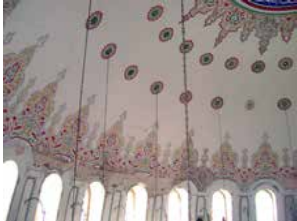
Fotoğraf 2 Merkezi Kubbe, Hasarlı Kubbe Yüzeyi
