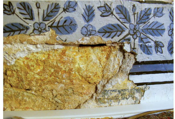
Fotograf 7. İç duvarların zemine yakın bölgelerinde sıva ve bezemelerdeki malzeme sorunları.
