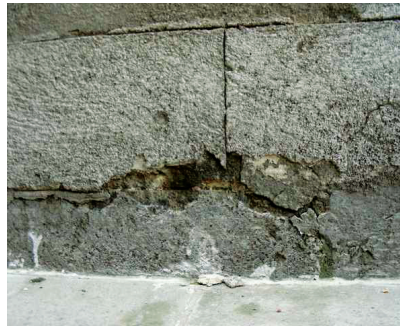
Fotoğraf 12. Cephenin zemin bölgelerinde bu kaplama malzemelerinde kapilariteye bağlı ortaya çıkan hasarlar.
