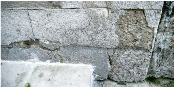
Fotograf 5-6. Duvar yüzeylerindeki onarım malzemelerinde kapilarinin neden olduğu hasarlar.
