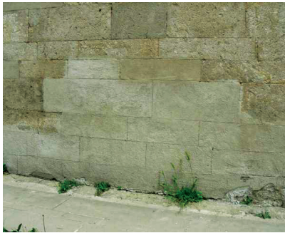
Fotoğraf 11. Cephe yüzeylerinde yapılan ve özgün yüzeylerle bütünlük göstermeyen imitasyon şeklinde sıva kaplama uygulamaları.
