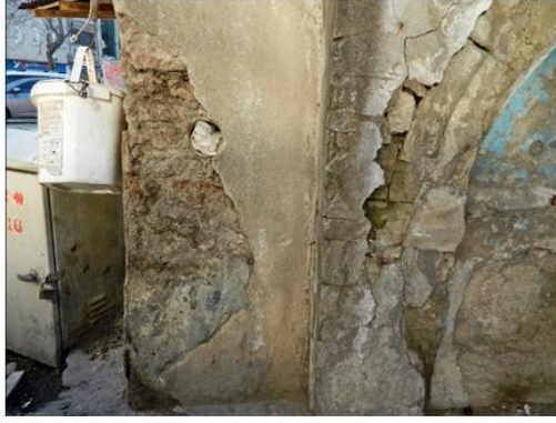
Şekil 2.69. Çeşme üzerinde oluşan bazı kırıklar (Özge Tokur, 2019)
