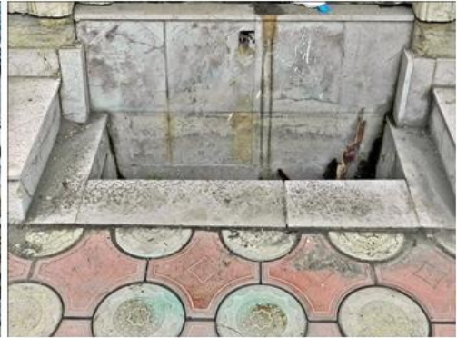
Şekil 2.143. Hüseyin Bey Çeşmesi'nde oluşan paslanmalar (Özge Tokur, 2019)
