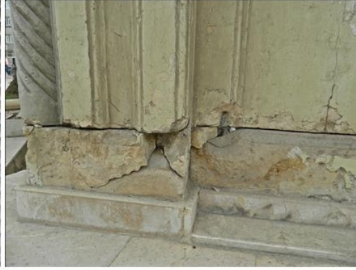
Şekil 2.104. Gövdede oluşan ayrılmalar (Özge Tokur, 2019)
