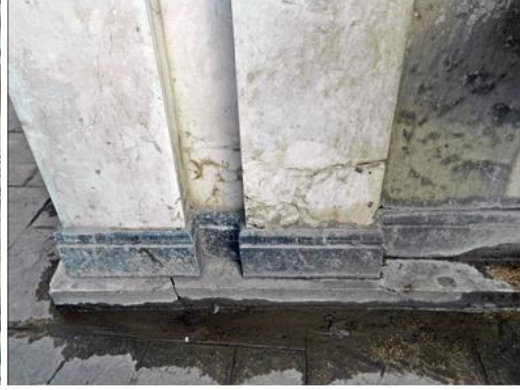
Şekil 2.46. Çeşmenin alt kısımlarında bulunan çatlaklar (Özge Tokur, 2019)
