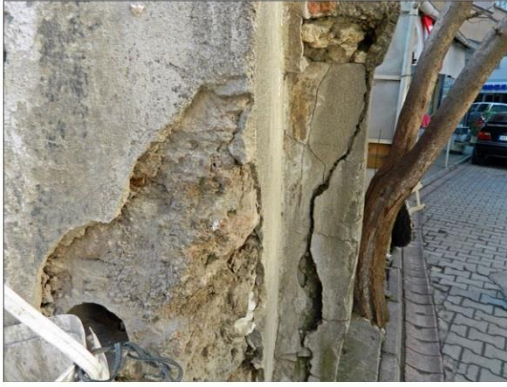
Şekil 2.75. Çeşme üzerinde bulunan çatlaklar (Özge Tokur, 2019)
