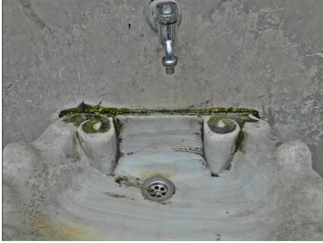
Şekil 2.145. Kadı Çeşmesi'nde oluşan yosunlanma (Özge Tokur, 2019)
