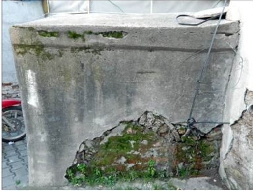
Şekil 2.146. Taşlı Çeşme'de oluşan yosunlanma (Özge Tokur, 2019)
