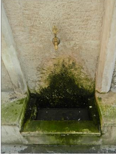
Şekil 2.144. Ali Bey Çeşmesi'nde oluşan yosunlanma (Özge Tokur, 2019)
