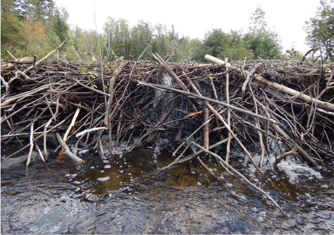
Photo 7. Forte perméabilité dans la portion supérieure du barrage nord illustrant une hauteur de chute élevée au niveau du site du barrage 1. Vue vers l'amont.
