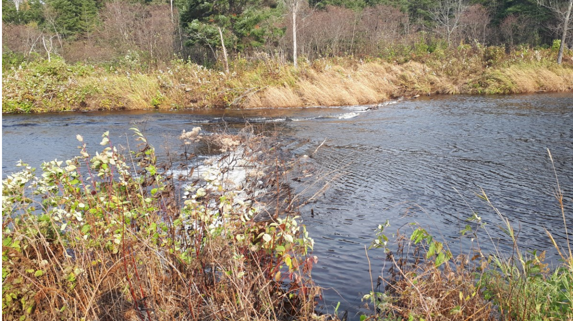
Photo 11. Barrage nord du site de barrage 4 le lendemain de la crue du 18 octobre 2020. Vue vers la berge droite.
