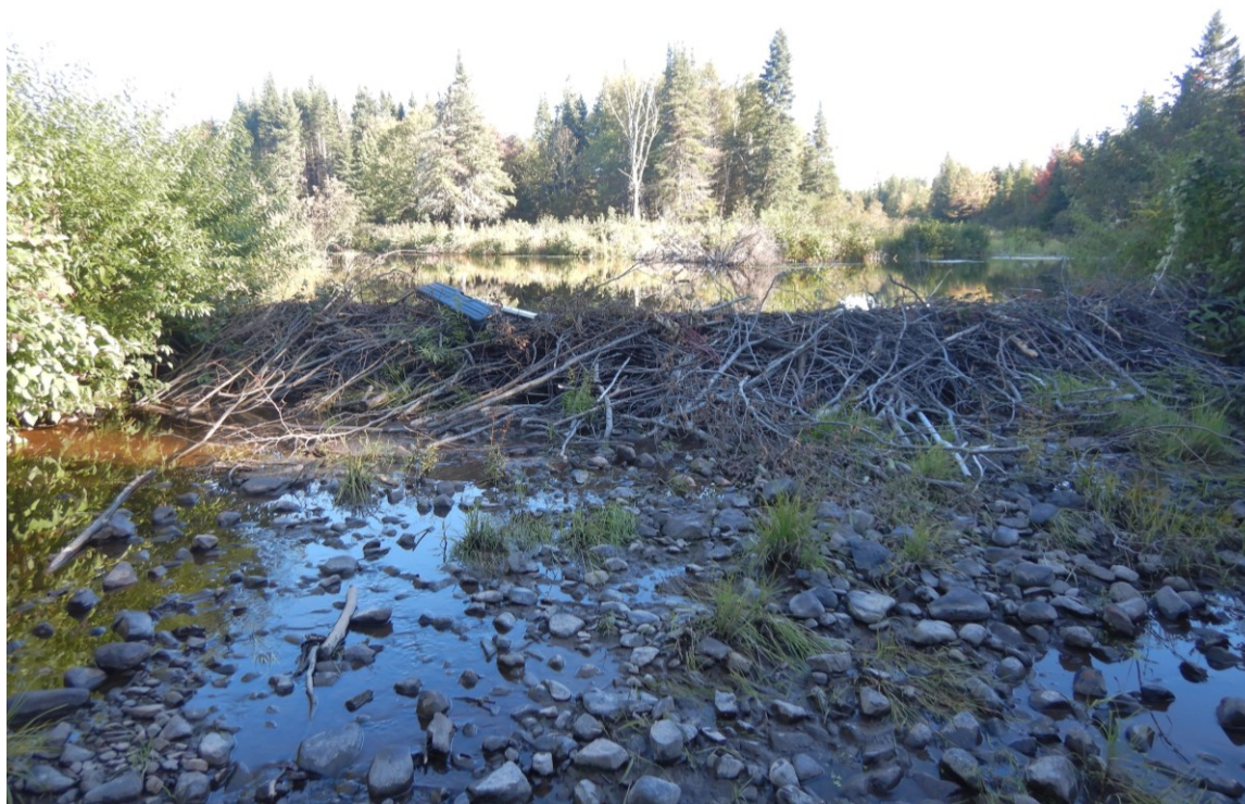
Photo 6. Faible perméabilité du barrage du chenal nord au site du barrage 1. Vue vers l'amont. La composition en limon du barrage était élevée.
