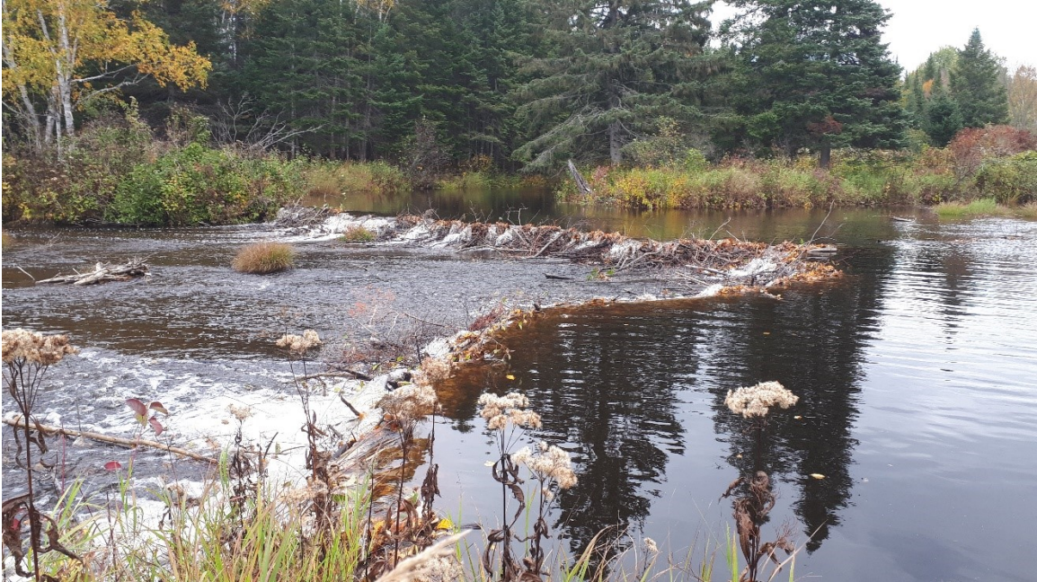
Photo 9. Barrage sud du site de barrage 1 le lendemain de la crue du 18 octobre 2020. Vue vers la berge droite.
