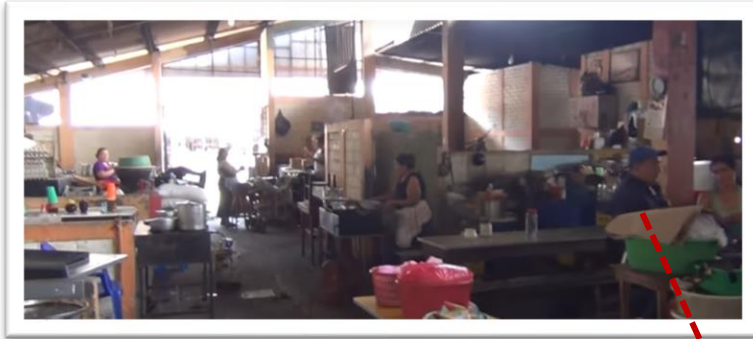
Imagen No. 25 El Puposódromo funciona como mercado de comida especializado en ventas de tortillas y pupusas, además de ventas de comida para llevar y algunas bodegas. La infraestructura se encuentra generalmente deteriorada, presenta grietas en paredes y columnas, así como roturas en láminas y filtración de agua.
