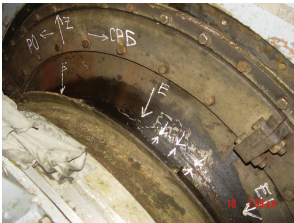
Slika 2.3 : Oštećenja na prelaznom radijusu R80 vratila turbine [1]
