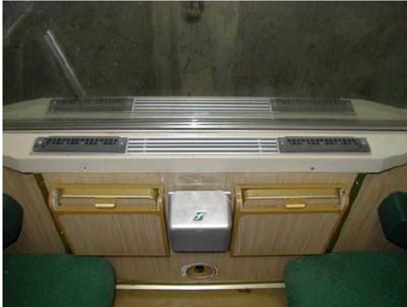
Figura 2. 9 - Sistema de climatização com difusão de ar por grelhas ao nível das janelas [16].
