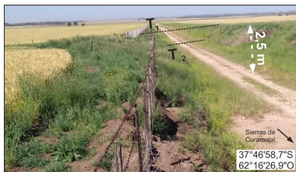
Figura 12.3. Erosión pluvial/aluvial en un camino vecinal del piedemonte occidental de las Sierras de Curamalal. T 1 : superficie del camino previa al evento de febrero de 1992. T 2 : superficie actual del camino. Flecha acotada: desnivel entre las superficies T 1 y T 2 . Modificado de Susena et al. (2019a). Foto: Juan M. Susena.
