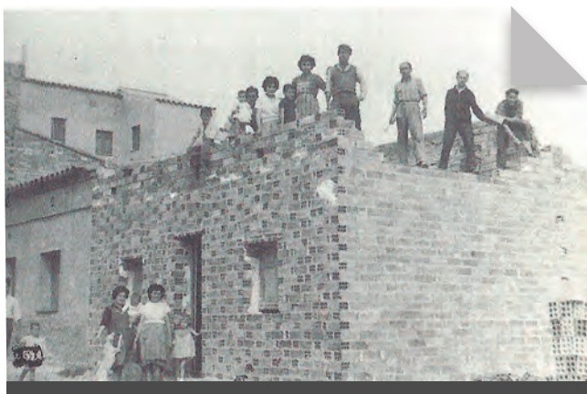
Fig. 1 - L'autoconstrucció es convertí en alguns barris, com als Magraners i al Secà de Sant Pere, en una pràctica habitual. Generalment es duia a terme els caps de setmana i hi participaven tant familiars com veïns.
