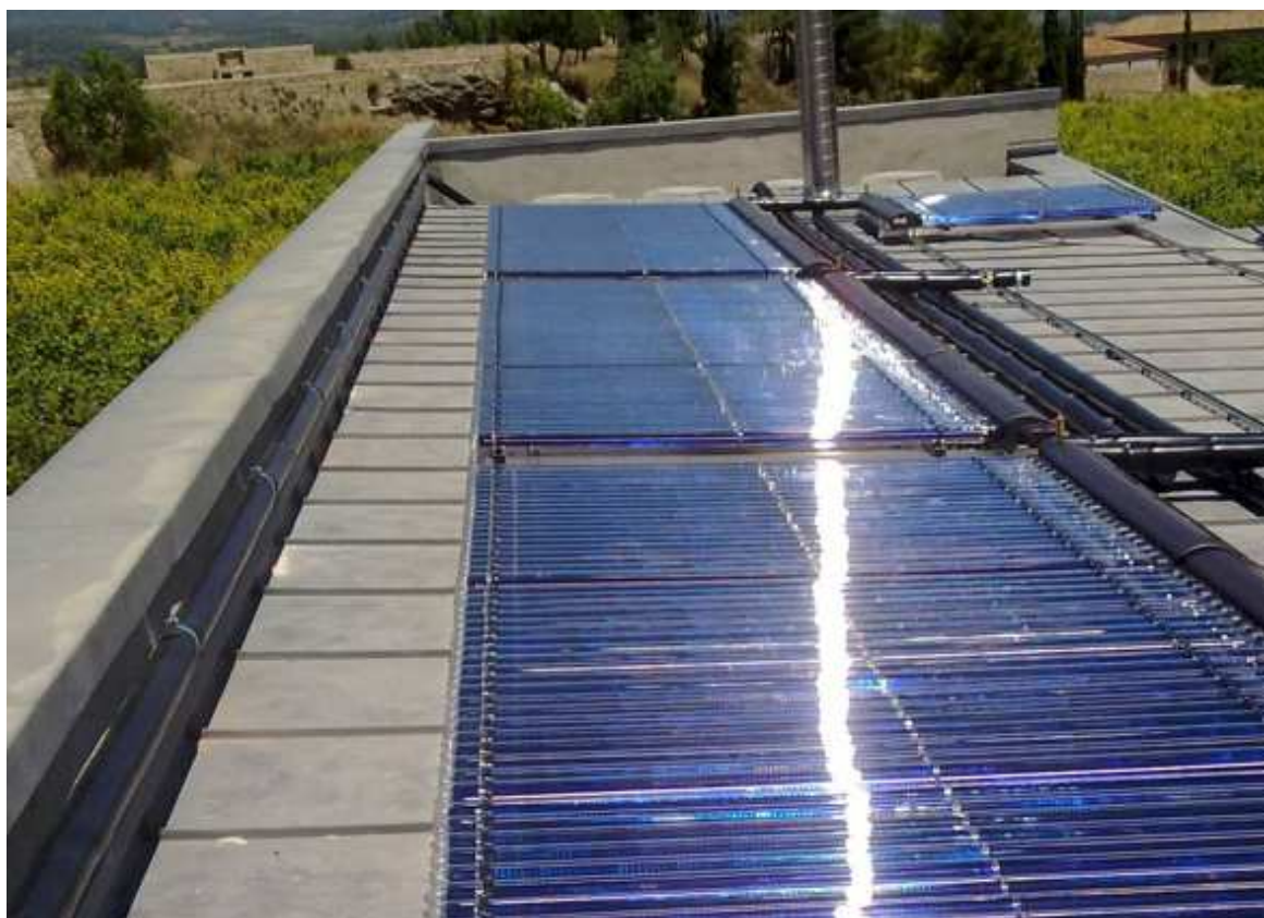
Tubs de buit, captadors solars tèrmics, a la teulada la nova hostatgeria externa de Poblet, que escalfen aigua per a l'equipament.
