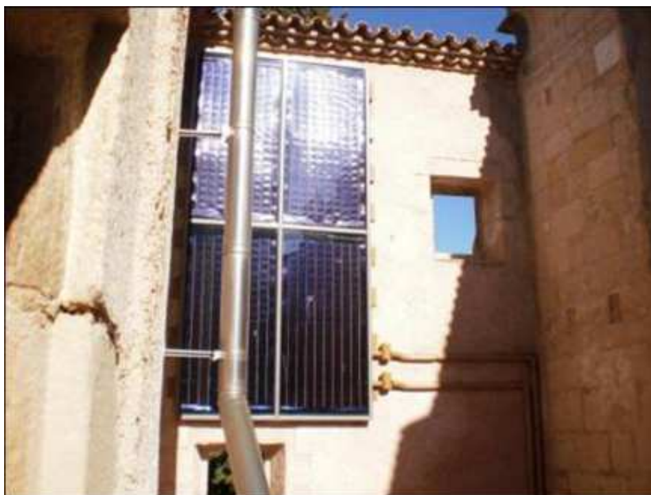
Captador solar tèrmic instal·lat a la Casa dels Germans de Poblet.
