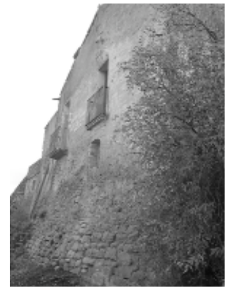
Detall de mur en què es pot apreciar l'atalussament de la part inferior
