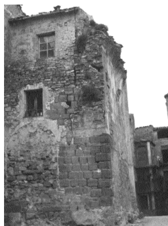
Vestigis gairebé imperceptibles de la primitiva església en els murs de la rectoria vella (fons A. Duran i Sanpere-AHCC)
