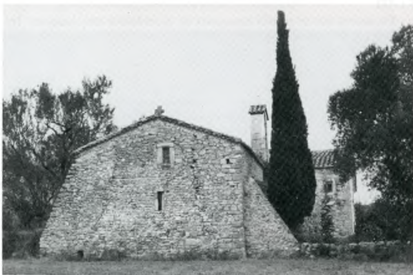
Fig. 8. Aspecte de la paret exterior encarada a ponent, amb l'aparellat vist. Dues perilles esquerdes justifiquen la presència dels dos contraforts oposats; a la part inferior esquerra, el desguàs per a evitar humitats a l'interior del temple. De les dues finestres, la superior ha estat inutilitzada; des de dintre, només es veu la inferior. Segons Joan Badia, la cantonada sud-oest (la de la dreta mirant la fotografia) «és l'únic vestigi antic que podem veure avui en aquest frontis».
