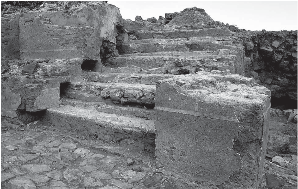
Figura 11. Detalle del primer tramo de la escalera de acceso al piso superior del alcázar.
