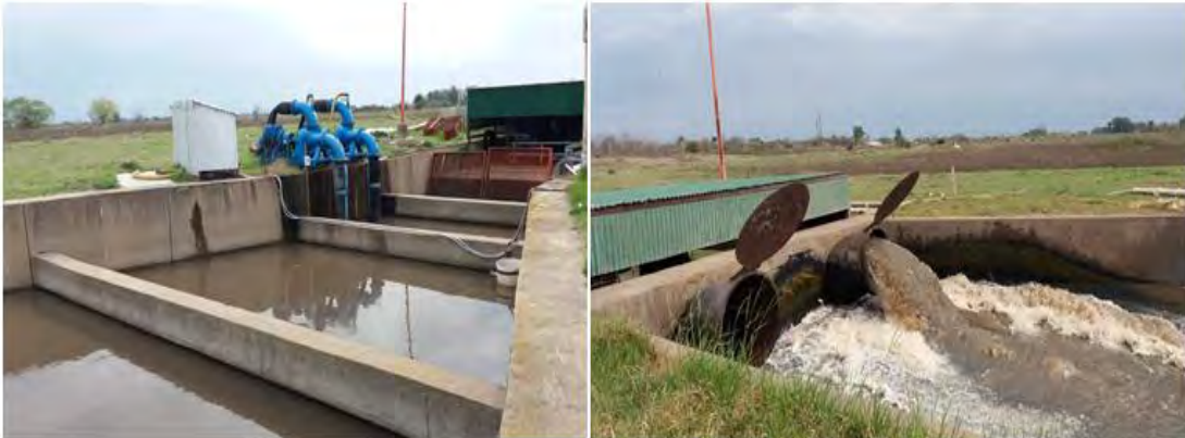
Figura 14. Estación de bombeo que extrae agua de la laguna (izquierda) y una de las bombas en funcionamiento (derecha).
