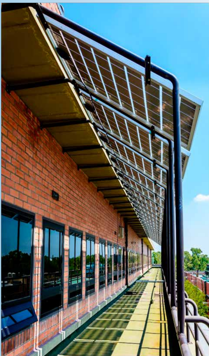
Figura 4: Pérgola fotovoltaica en el Edificio TANDAR del Centro Atómico Constituyentes de la CNEA.
