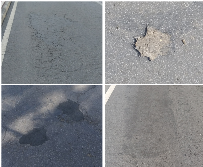
Figura 5.19: Anomalias encontradas na Rede viária urbana do Trecho 2 - Fendilhamento, Covas e Reparações, em sentido horário (Autoria própria)
