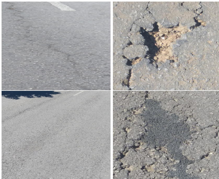
Figura 5.8: Anomalias encontradas na Rede viária urbana do Trecho 1 - Fendilhamento, Covas, Reparações e Def. sup., em sentido horário (Autoria própria)
