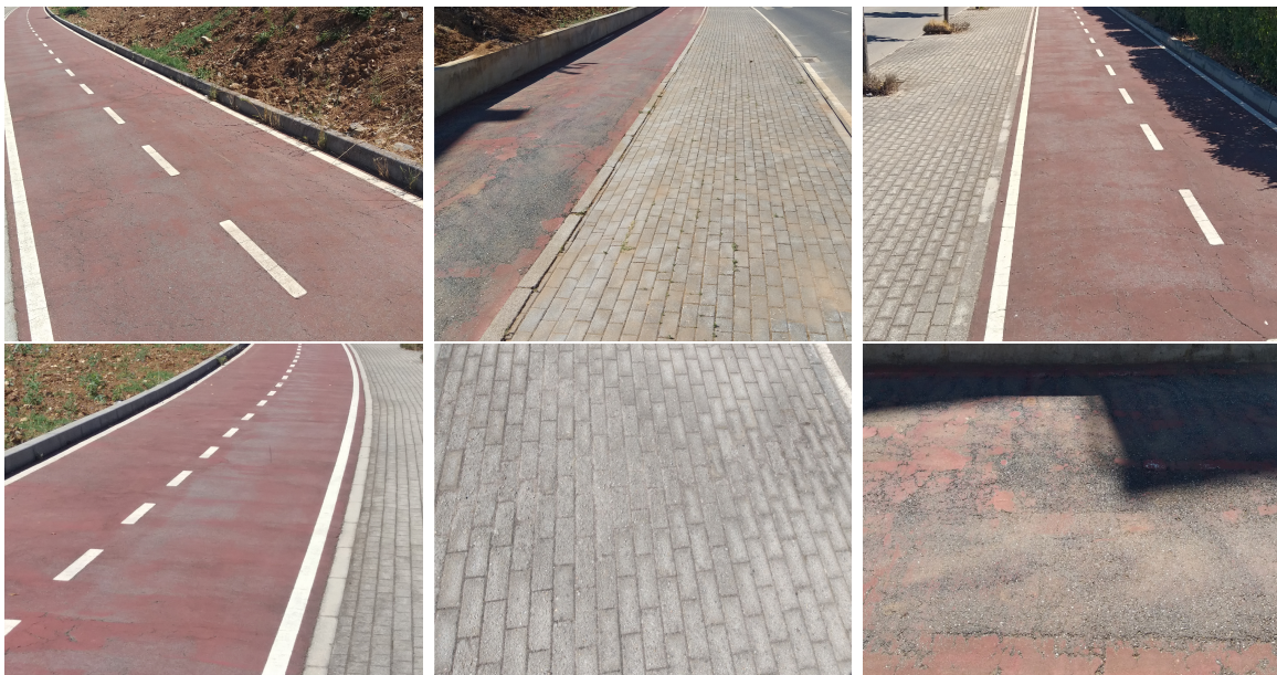
Figura 5.12: Fotografias do estado das Redes pedonal e ciclável do Trecho 1 (Autoria própria)
