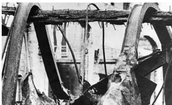
Figura 14 - Vigas em aço e madeira após incêndio, [41].
