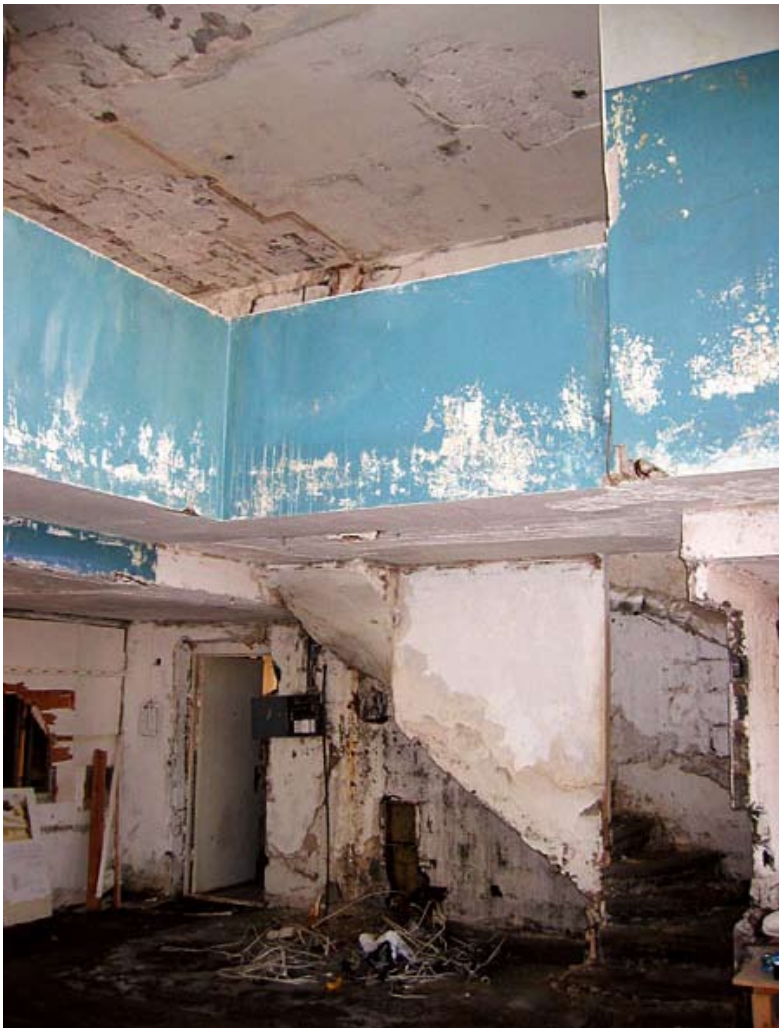
Estado actual de una de las células tipo Ken en el edificio semi-colectivizado Narkomfin. Moisej Ya. Ginzburg, Ignaty Milinis. Moscú, 1928-1930.
