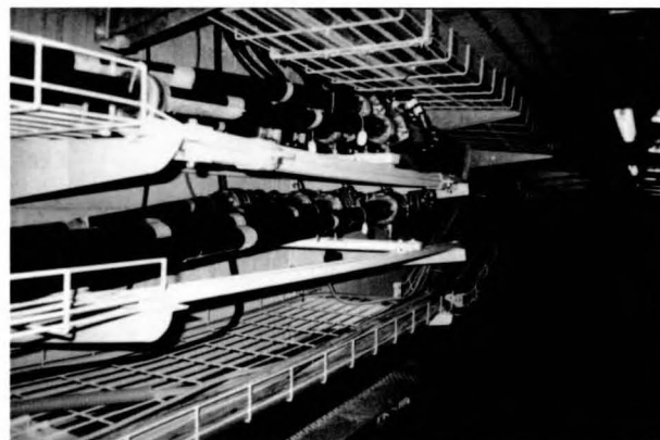
Canalización subterránea del entramado de guías por las cuales se van propagando las diferentes señales que transmite la zona de control hacia el campo de antenas.
