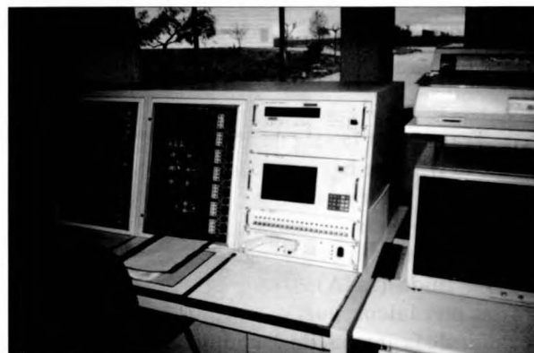
Paneles de monitorización de las señales a transmitir, en su camino desde el centro de control a las antenas.
