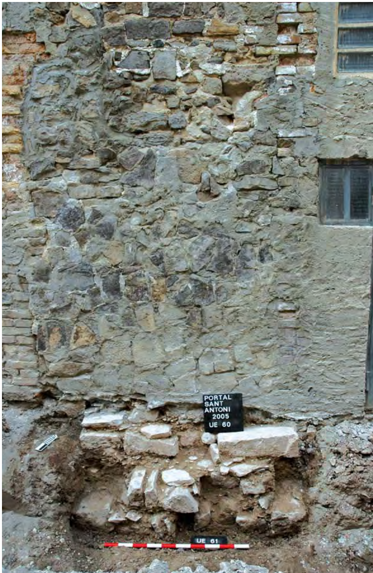
Fig. 8. Detall de la UE 60, continuació de la muralla del segle XIV vers el castell.
