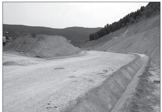
Lámina II. Vista del vial superior del PAI "El Castellar", en el que se puede observar la magnitud de los movimientos de tierras que ocasionaron la destrucción total de la necrópolis del Olivars dels Jordans, cuyos únicos restos documentados lo han sido en el montículo a la izquierda de la foto.
