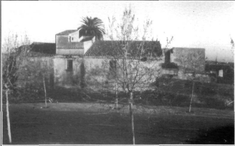
Façana posterior de la masia de Can Boet abans de l'inici de les obres de consolidació. Fotografia Enric Subià.
