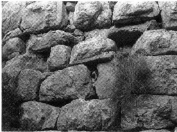
Fig. 15.- Detall de dos forats oberts en el sector sud del mur de la torre.
