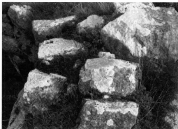
Fig. 10.- Sistema de construcció de murs en el qual s'observen les dues filades concèntriques i el reompliment interior de pedruscall i pedres de grandària menor.
