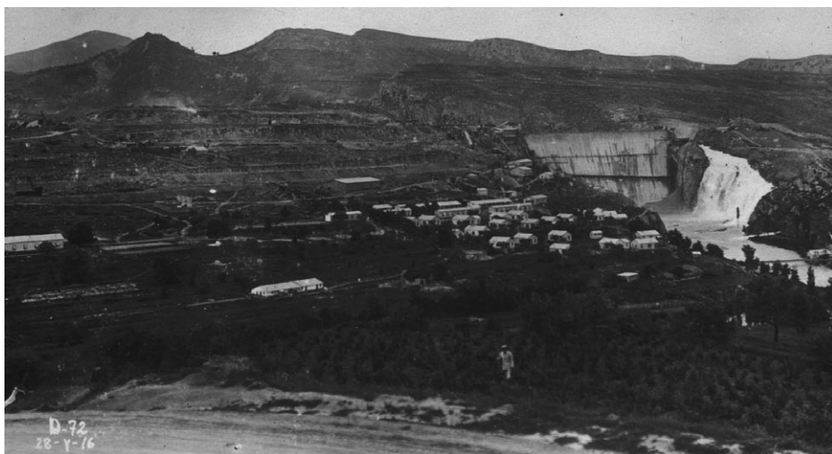
La presa de l'embassament de Talarn en la fase final de les obres de construcció. Al costat, el campament de Sant Antoni destinat a l'allotjament de part dels treballadors (28-V-1916). Arxiu Izard Forrellad. Lleida.
