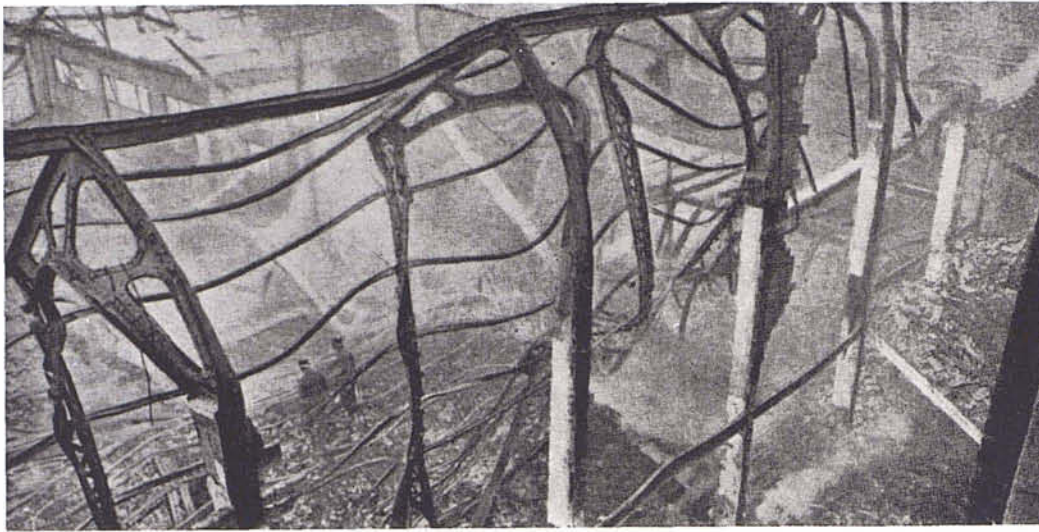
Cerchas metálicas en la «Sala Imperio» tras el incendio.
