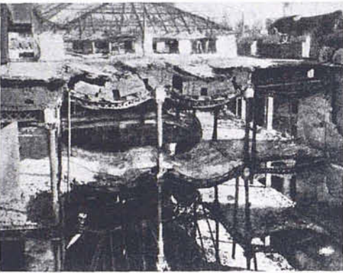
Portentoso pandeo de jácenas de celosía en el cuerpo de edificio de la calle de Xuclá.
