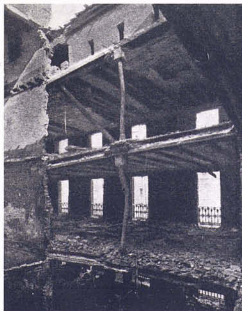
Increíble deformación de las columnas de fundación en la crujía de fachada a la Rambla.
