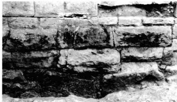
Figura 3. Detall de la fonamentació de la torre de llevant de les defenses urbanes (Torre Gironella).
