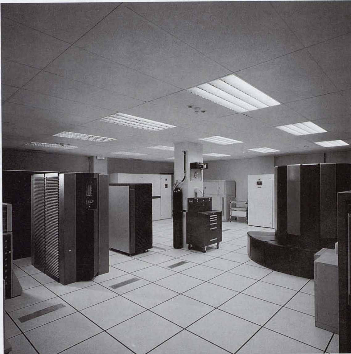
VISIÓN GENERAL DE LA SALA DE ORDENADORES DEL CESCA
